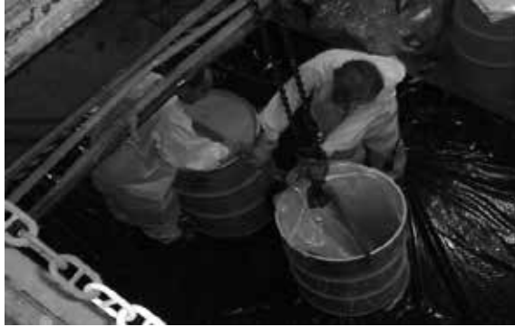
Figura 3 – Retirada de resinas e carvão do sistema de retratamento.
