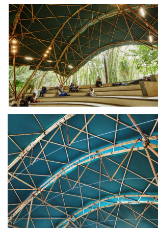
Figura 21: Vista interna da estrutura do Anfiteatro da PUC-Rio, empregando tubos de bambu, membranas acrílicas e conexões flexíveis em cabos de poliéster. Fonte: Bambutec, 2014.
