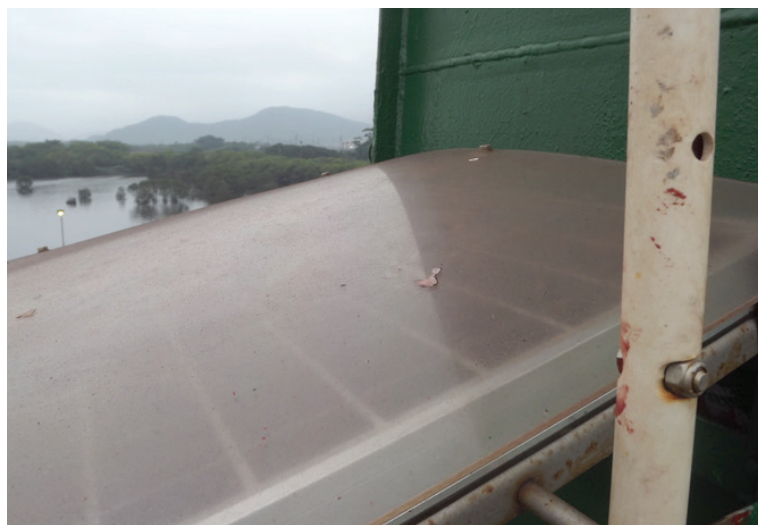
Figura 69 Painel solar afetada pela presença de poeira
