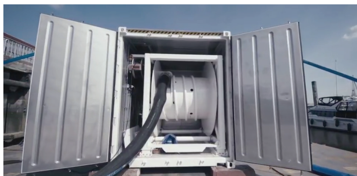
Figura 33 Sistemas de mangueiras para conexão entre o navio e a unidade de tratamento em terra
