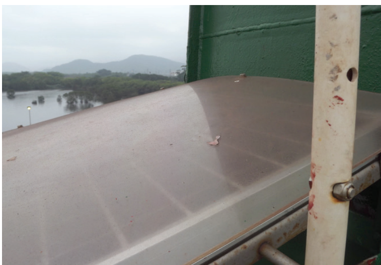
Figura 69 Painel solar afetada pela presença de poeira
