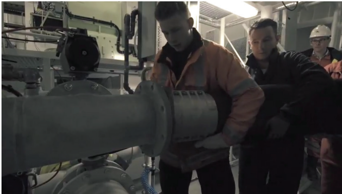
Figura 34 Sistema de conexão da mangueira para realização da coleta da água de lastro do navio 4
