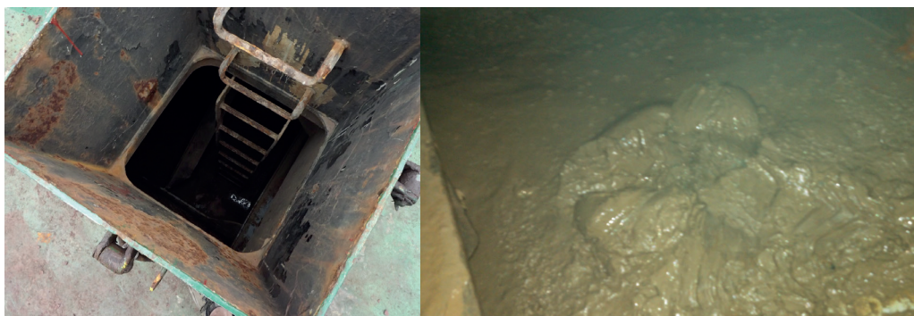
Figura 6 Acúmulo de sedimentos no fundo e na parede dos tanques
