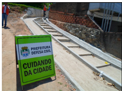
Figura 9: Soluções atuais adotadas em São Luís – MA. Fonte: Setor de Obras – SEMOSP, 2015.
