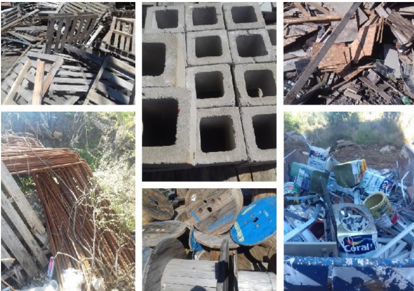
Figura 4: Resíduos identificados em canteiro de obra. Fonte: Registrado pelas autoras, 2016.
