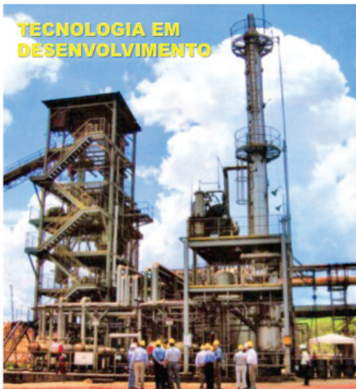
COLUNA DE RECUPERAÇÃO DO SOLVENTE (ETANOL, QUE RECIRCULA) E DE SEPARAÇÃO DOS PRODUTOS DA HIDRÓLISE COLETA DOS PRODUTOS DA DESTILAÇÃO: HIDROLISADO E LIGNINA
