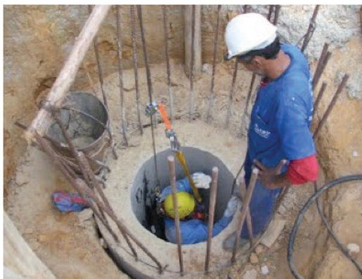
Figura 8 – Trabalho em espaço confinado: execução de fundação do tipo tubulão de ar comprimido. Fonte: Naresi, 2010.
